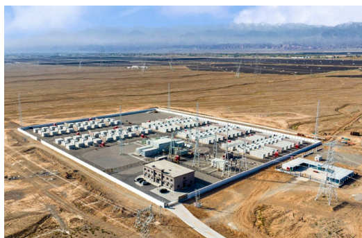
甘肃某地 1000MWh
